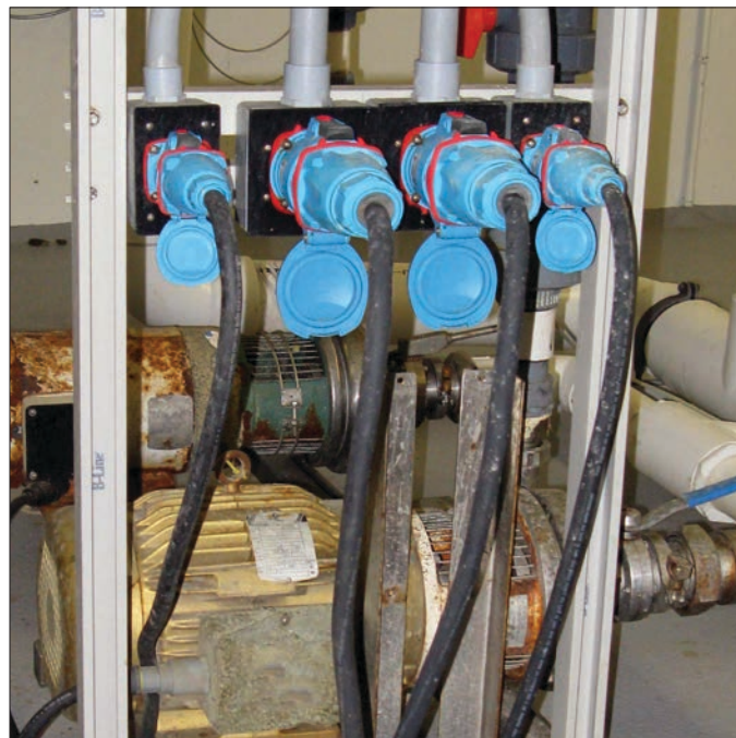
Cuatro dispositivos Certificados como Seccionador MELTRIC proporcionan energía a bombas individuales utilizadas para vaciar los tanques de almacenamiento para varios tamaños de pepinillos
