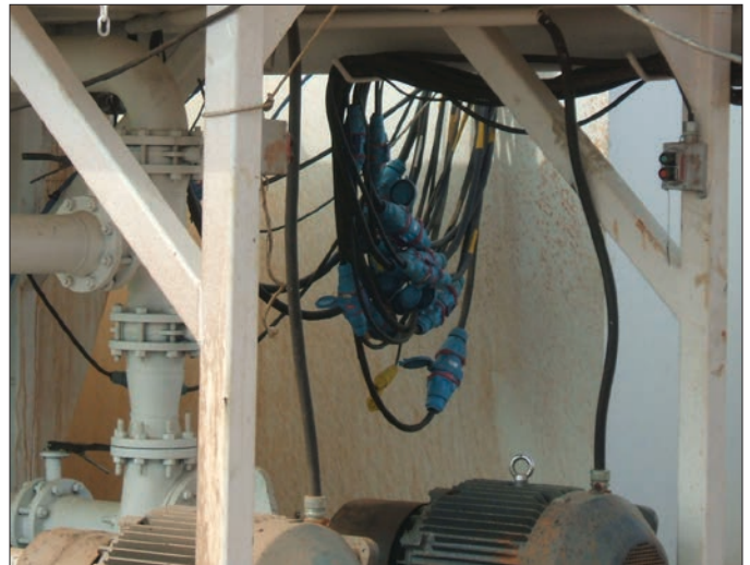
Motores eléctricos que operan con 440 VCA están entre el equipo conectado con dispositivos Certificados como Seccionador, los cuales pueden verse arriba.
