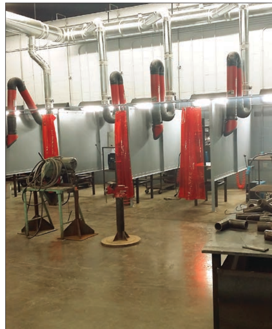
Los intercambios de equipo para soldar en el Colegio Odessa son simples y seguros porque los tomacorrientes Certificados como Seccionador MELTRIC protegen a los operadores de las partes energizadas y eliminan el arco eléctrico en la desconexión.
